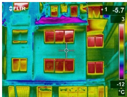
Termogram razgibane fasade večstanovanjske stavbe.
