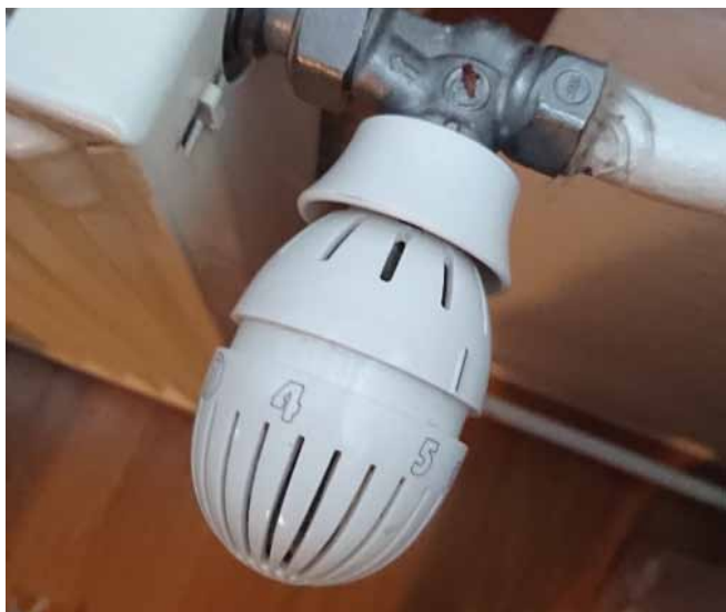
Celovita energetska prenova zahteva celovite ukrepe na sistemu ogrevanja, kamor ne sodijo le termostatski ventili na radiatorjih
