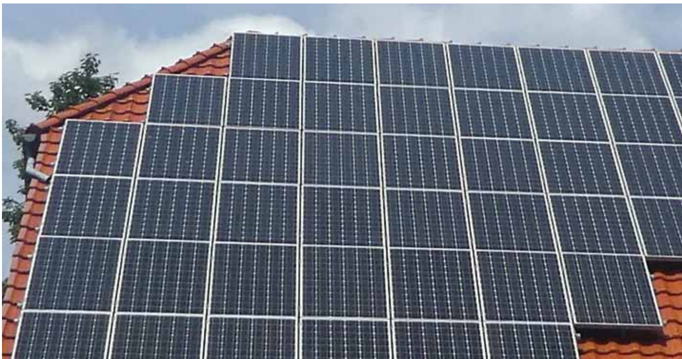
Samooskrbna sončna elektrarna na večstanovanjski stavbi na Jesenicah, vir: GEN-I, 2019
