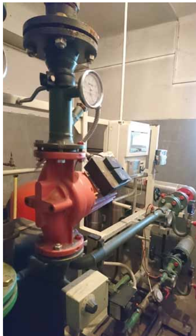
Eden izmed ukrepov pri celoviti energetski prenovi večstanovanjske stavbe je zmanjšanje priključne moči toplotne postaje.
