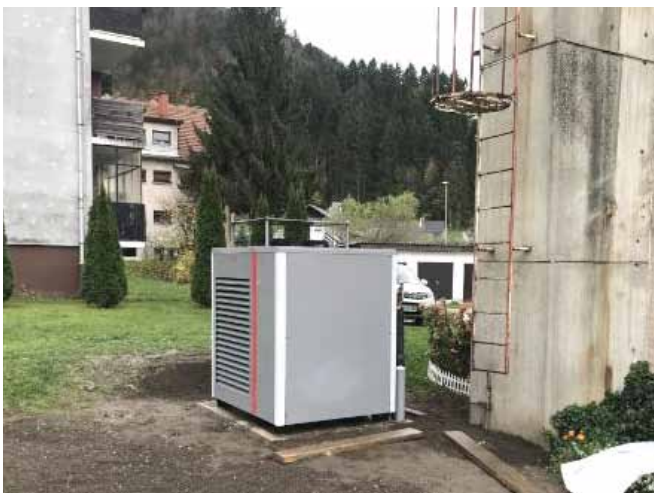
Toplotna črpalka za ogrevanje in pripravo tople sanitarne vode v večstanovanjski stavbi, vir: Kronoterm
