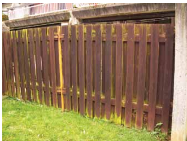
Alge opazimo tudi na vrtnih ograjah in drugih elementih zunanje ureditve, in ne le na fasadah
